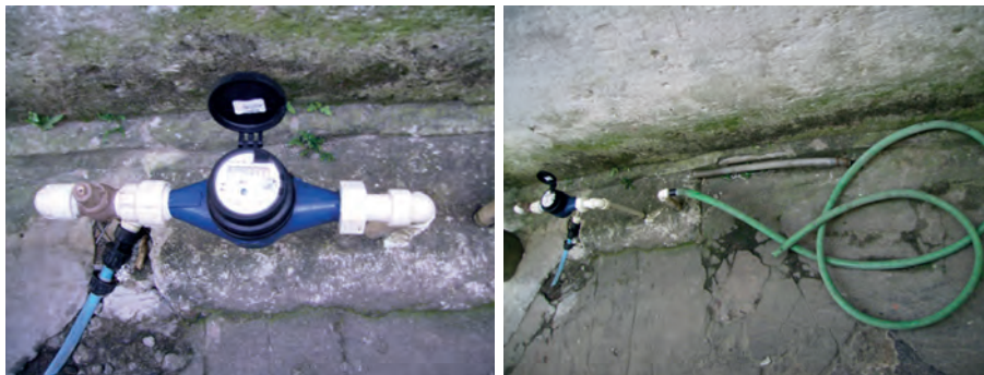
FIGURA 3 Hidrômetros e mangueiras conectadas
